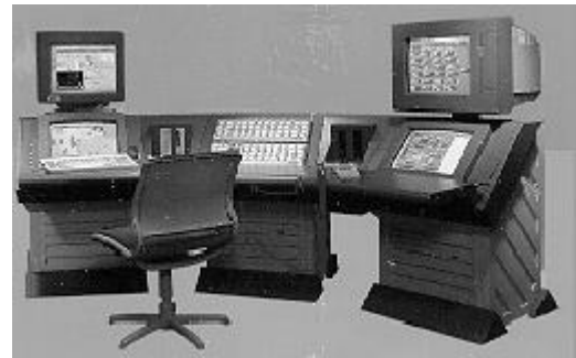
Fig. 8.14. Estação de operação típica do SDCD
